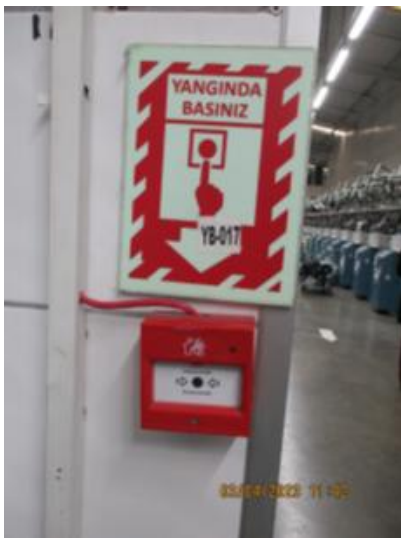
FIRE ALARM BUTTON.JPG
